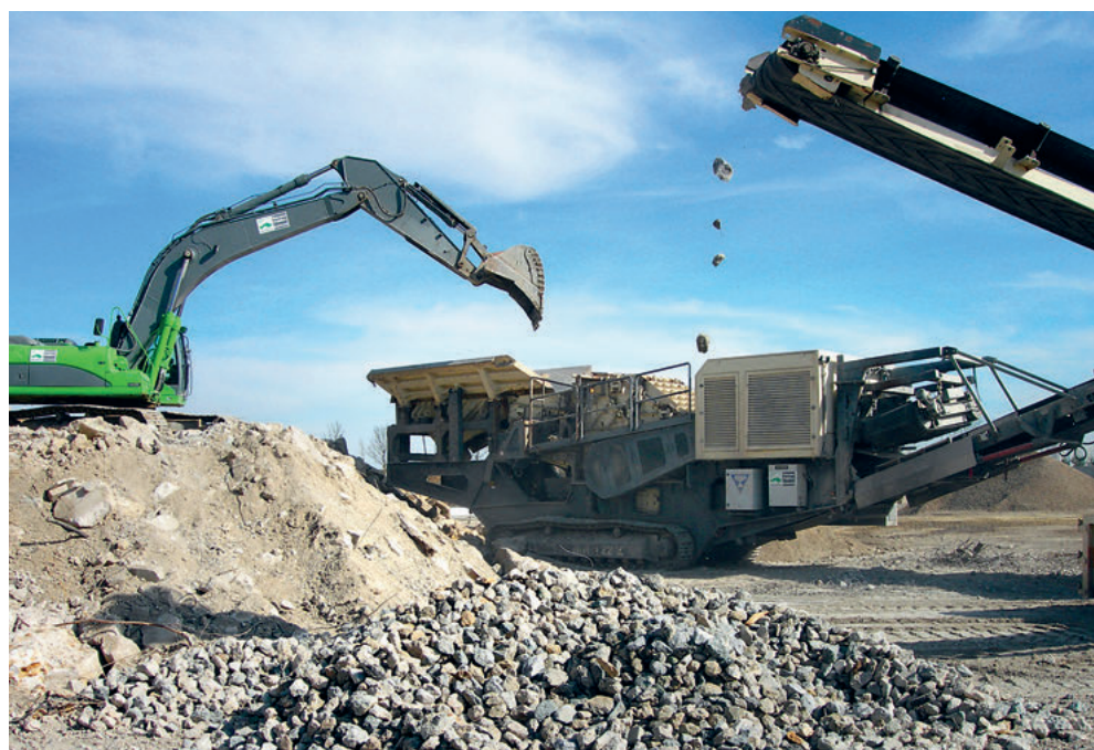
Le projet COFRAGE a permis d'optimiser deux techniques séparatives des constituants du béton. Elles sont efficaces pour la récupération de granulats réutilisables. © BRGM
